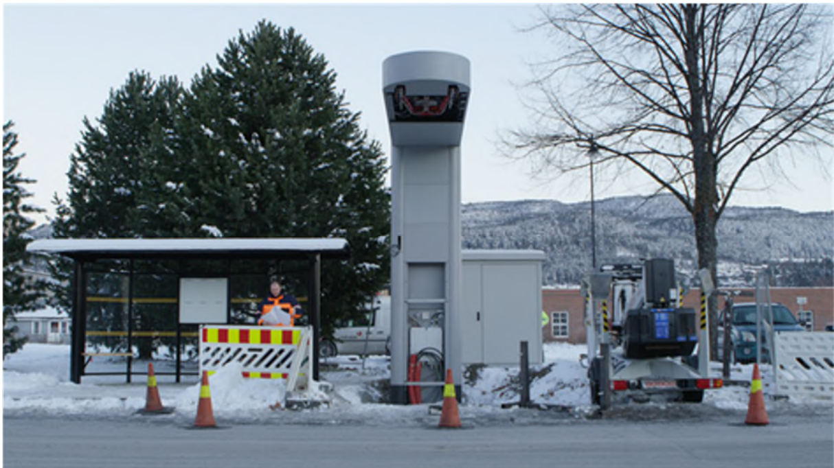
Figur 3.7: Faktisk ladeinfrastruktur (pantograf og teknisk hus) og lehus på Mjøndalen stasjon pr. 30.11.2017 (foto: Brakar).
